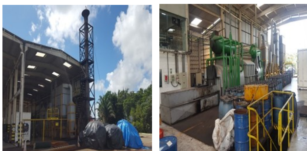
Figura 23 – Incinerador de resíduos sólidos da Maxtec Serviços, instalado em São Luís.
